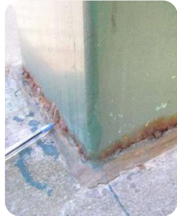
خوردگی سطحی جوش همراه ترکهای مویی غیر ممتد وجود دارد.
